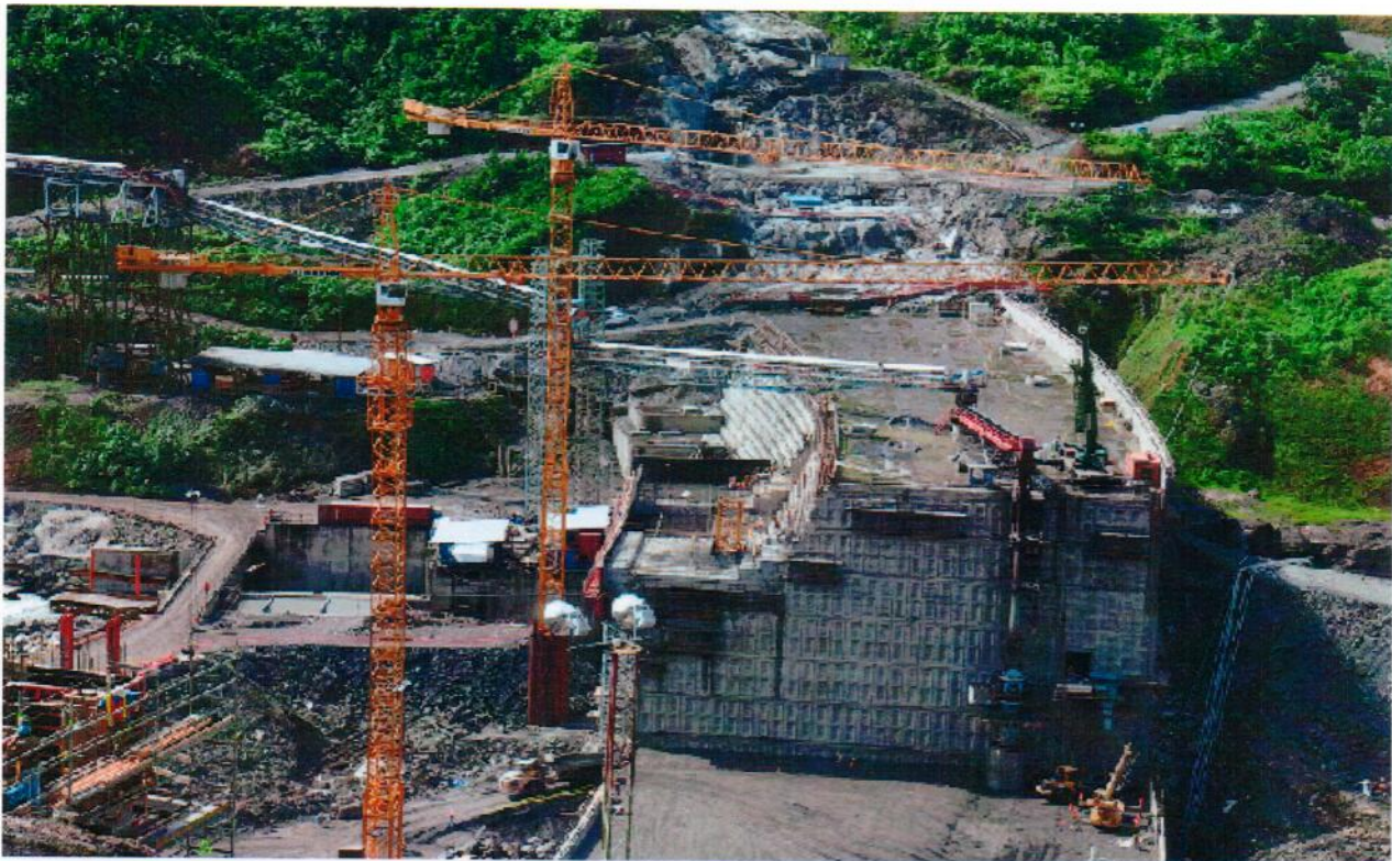
CENTRAL HIDROELÉCTRICA DE CHANGUINOLA – 223 MW
